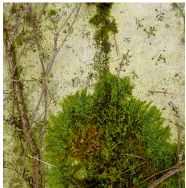
Bild 8: Moosbewuchs (ein Kurzbüchsenmoos, Brachythecium sp.) an einer Wand, die von Wildem Wein ( Parthenocissus tricuspidata ) berankt wird. [© Fraunhofer-Institut für Bauphysik Holzkirchen]
