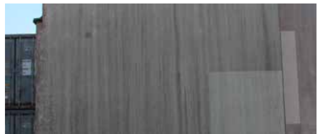
Bild 2: Gebäude mit Aufwuchs, dominiert von Pilzen in typischen Ablaufspuren („Tiger-Effekt“). [© Fraunhofer-Institut für Bauphysik Holzkirchen]
